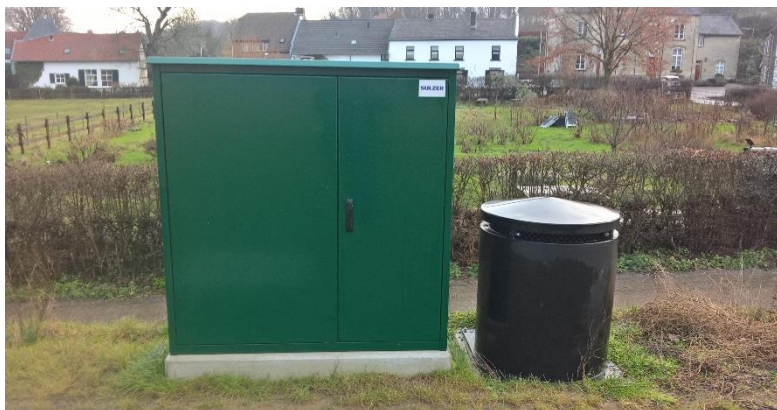
Figuur 4-a Complexe installaties vragen meer onderhoud
